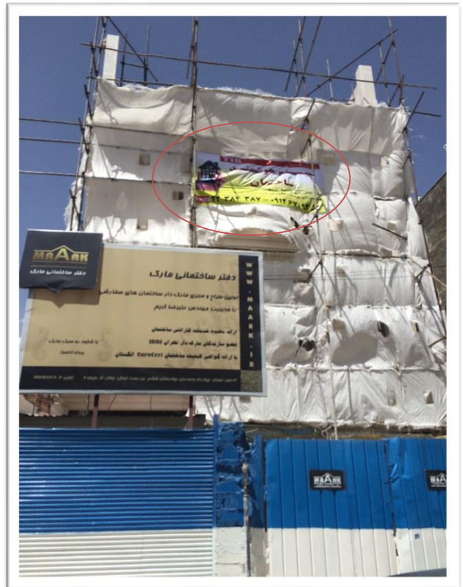
۵۲. طراحی و اجرای هوشمند سازی ساختمان مسکونی تریبلکس آقای مهندس کریم ۲۰۲ تهرانپارس
