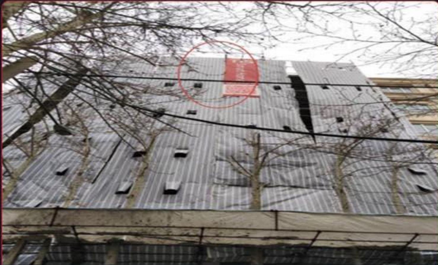
۱۳- پروژه هوشمندسازی ساختمان مسکونی ۱۲ واحدی پاسداران کارفرما : جناب آقای علیزاده
