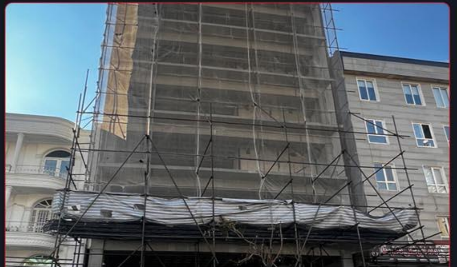
۸- پروژه هوشمندسازی ساختمان اداری ۱۰ واحدی - شریعتی کارفرما : جناب آقای خوشی
