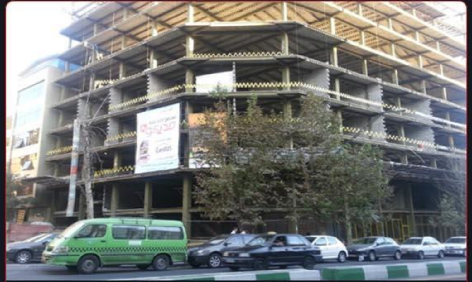
۳۴- پروژه هوشمندسازی مجتمع اداری تجاری مدیکو - ولیعصر کارفرما : —
