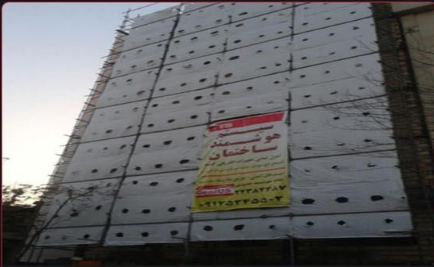
۲۱- پروژه هوشمندسازی ساختمان مسکونی ۱۸ واحدی منیریه کارفرما : جناب آقای بهمن پور
