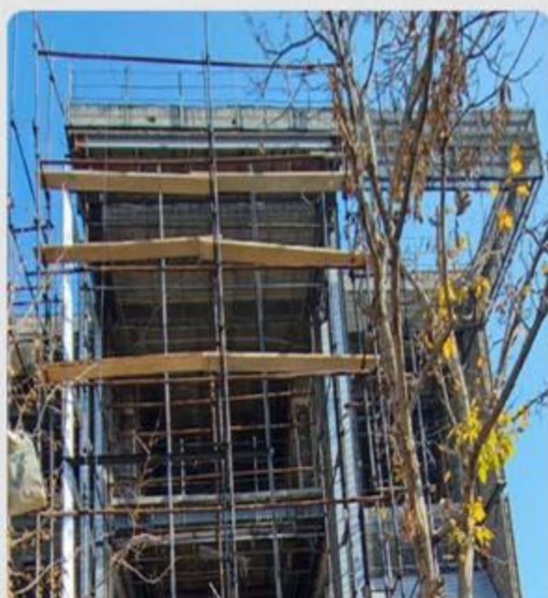
۵۰- ویلا تریبلکس کمربندی لواسان کارفرما : جناب آقای سبزی کار مالک اطلس پلاس
