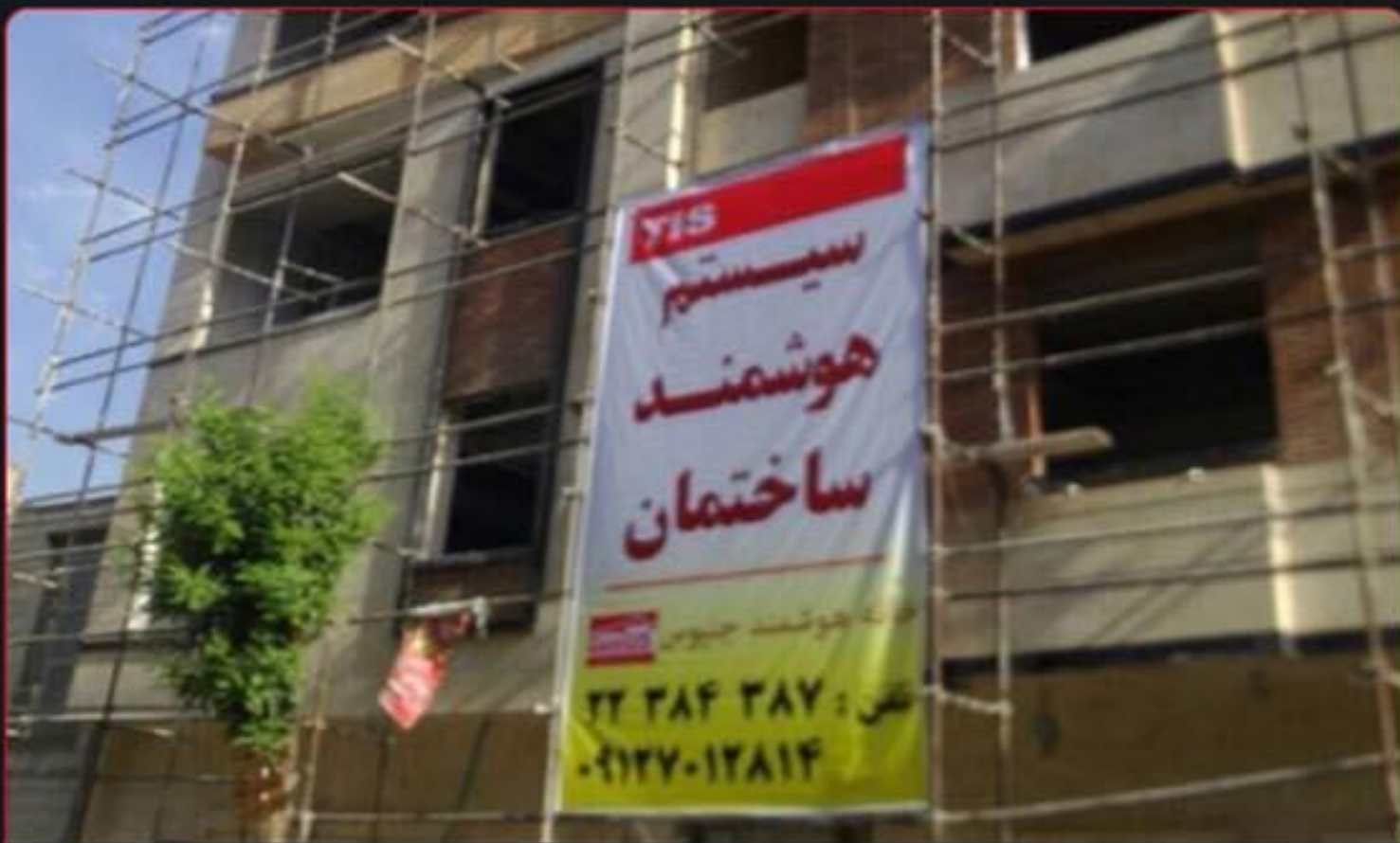
۱۵- پروژه هوشمندسازی ساختمان مسکونی ۱۲ واحدی - خیابان پیامبر کارفرما : جناب آقای احمدی
